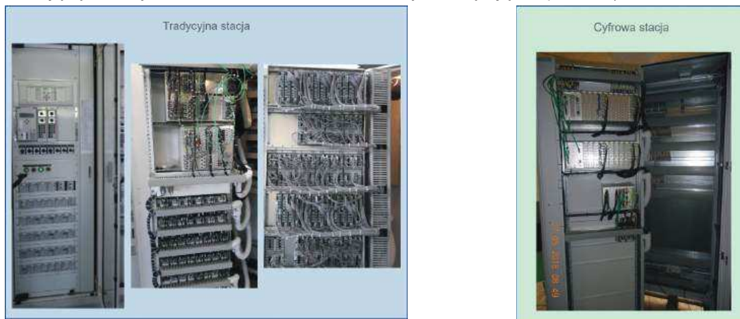
Rys. 1. Stacja Cyfrowa 110kV (2016r) – diagnostyka, szybsza reakcja i tańsza eksploatacja, szybszy montaż obwodów wtórnych, mniej czasu na uruchomienie pola
