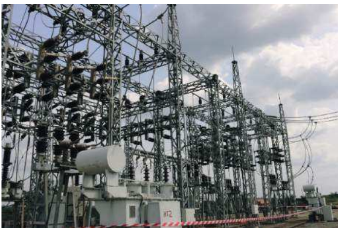
Rys. 8. Stacja Umahia 132 kV z izolacją powietrzną
