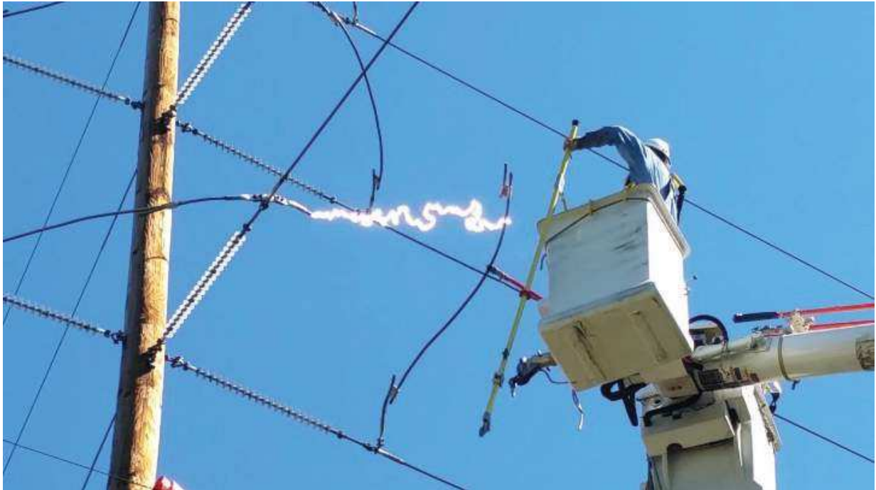
Rys. 2. Przykład łuku elektrycznego zainicjowanego na linii napowietrznej SN
