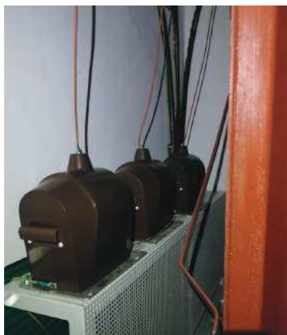
Rys. 3. Zamontowane dla celów diagnostycznych przekładniki 30 kV
