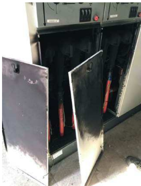
Rys. 6. Pole rozdzielnicy SN 20kV zniszczone po wybuchu łuku elektrycznego
