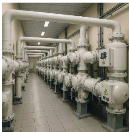
Rys. 9. Rozdzielnia typu GIS
