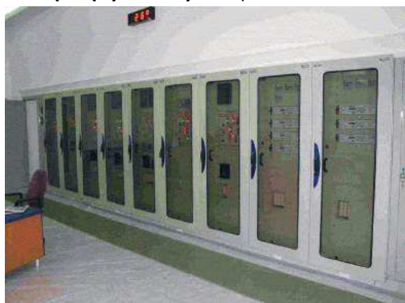
Rys. 3. HPP Spilje – szafy EAZ pól 110 kV
