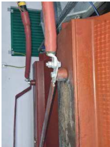
Rys. 2. Brak zainstalowanych ograniczników przepięć po stronie GN transformatora
