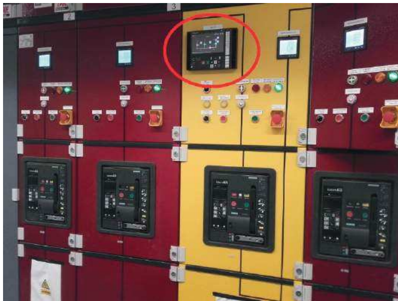
Rys. 7. Zabudowa automatów APZplus w rozdzielni
