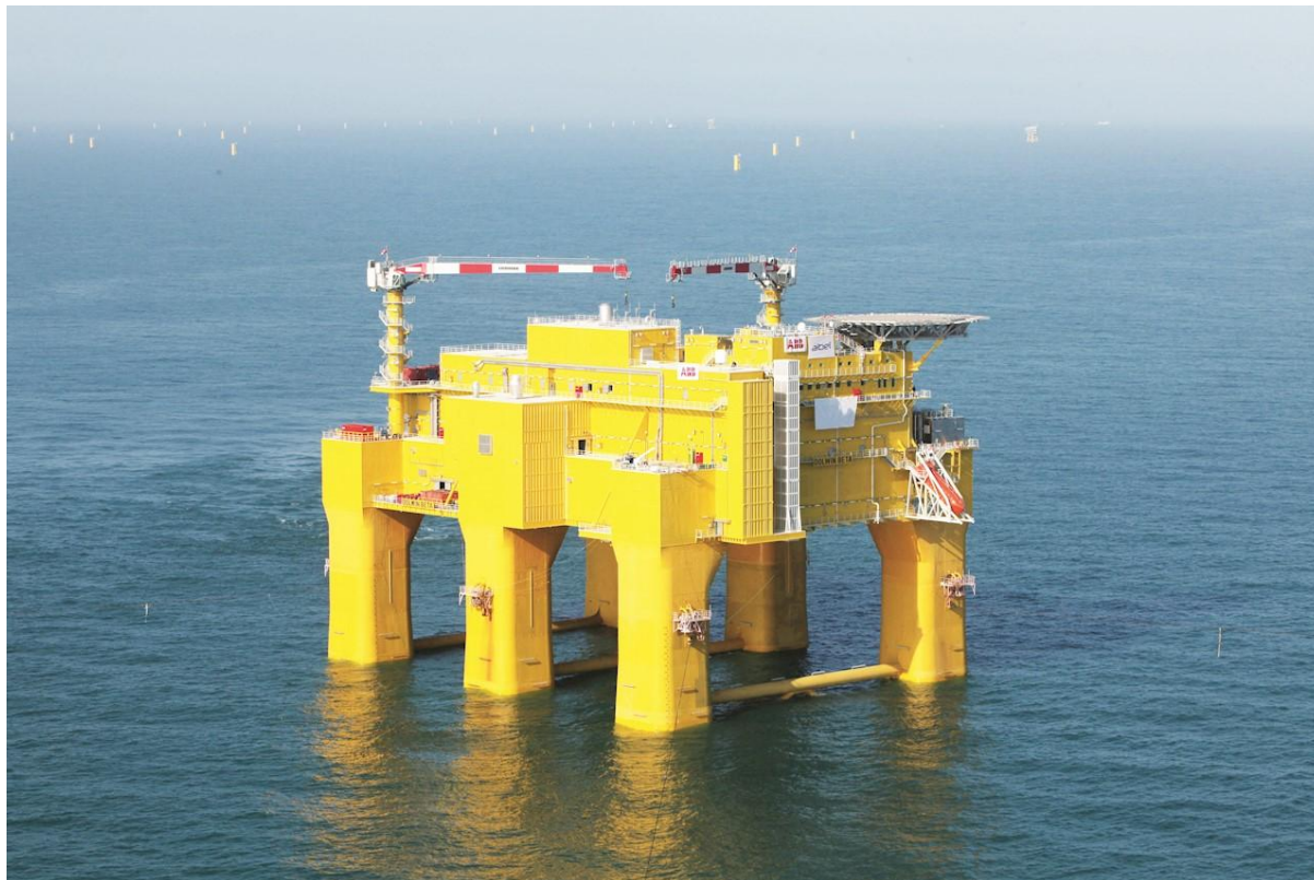
Rys. 8 Stacja morska HVDC DolWin2. Źródło: Strona internetowa ABB [14]
