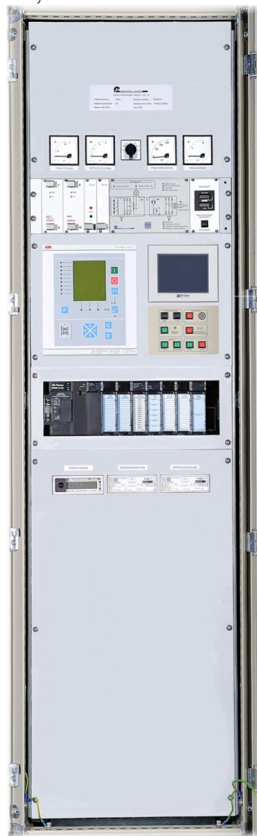
Rys.1 Szafa regulatora w ETA
