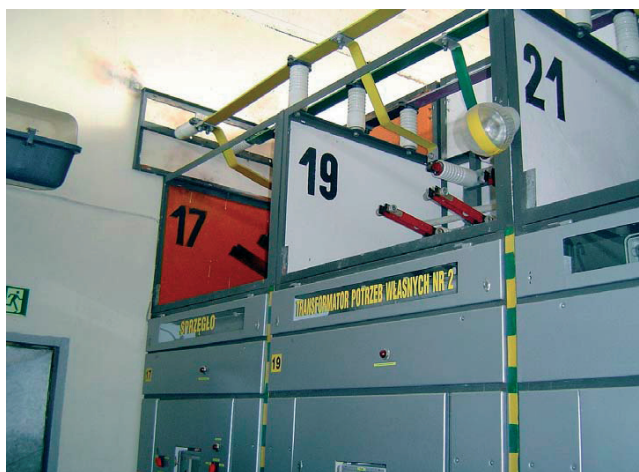
Rys. 13. Miejsce zwarcia – uszkodzony izolator wsporczy
