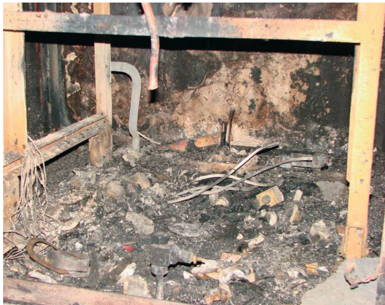
Rys. 1. Prawdopodobne miejsce powstania zwarcia. Przyłącze kablowe.
