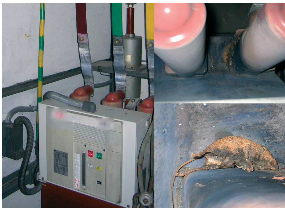
Rys. 11. Miejsce, w którym doszło do zwarcia – obszar pomiędzy komorami wyłącznika.
