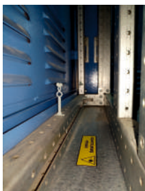
Prowadzenie pętli w rozdzielni nN
